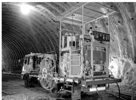
写真は爆薬の遠隔装填装置
