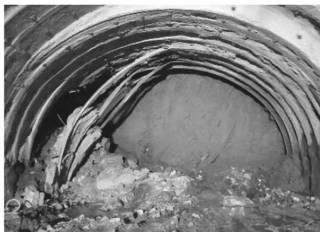
写真は支保変状状況(葉片状蛇紋岩)
