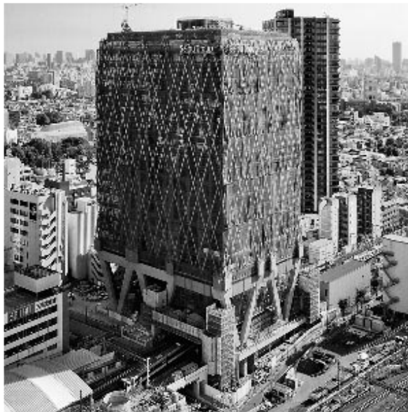
写真はダイヤゲート池袋の新築にあわせて地下通路を構築している状況
