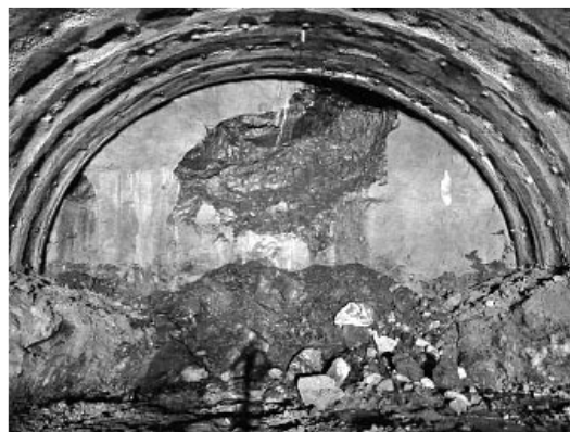
写真は切羽崩落状況
